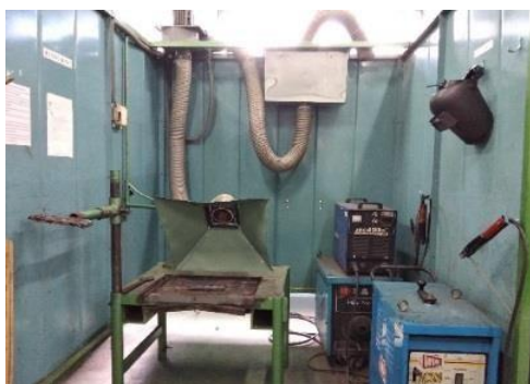
Hình 1. Hiện trạng buồng hàn và thiết bị xử lý khói hàn
