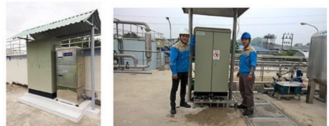
TRẠM QUAN TRẮC NƯỚC THẢI TỰ ĐỘNG
