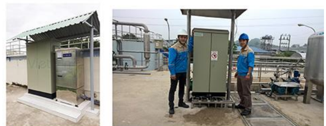
TRẠM QUAN TRẮC NƯỚC THẢI TỰ ĐỘNG
